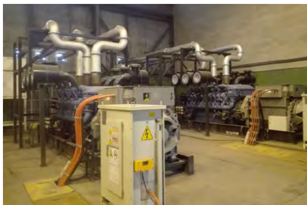
پروژه برق اضطراری فولادسازی
