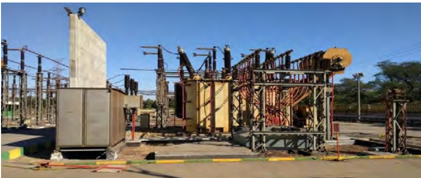
پروژه توسعه پست اصلی ۲۳۰ کیلو ولت
